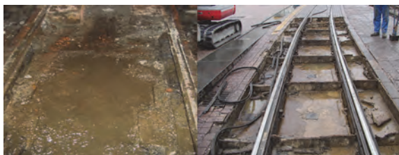
Slika 2. Stanje unutar tramvajskog kolosijeka s lošom odvodnjom
